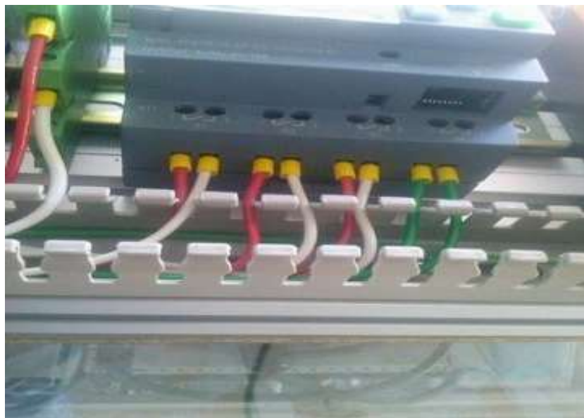
Figura número 24: Cableado.
