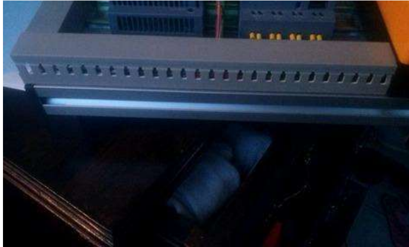
Figura número 21: Canaletas para el cableado.
