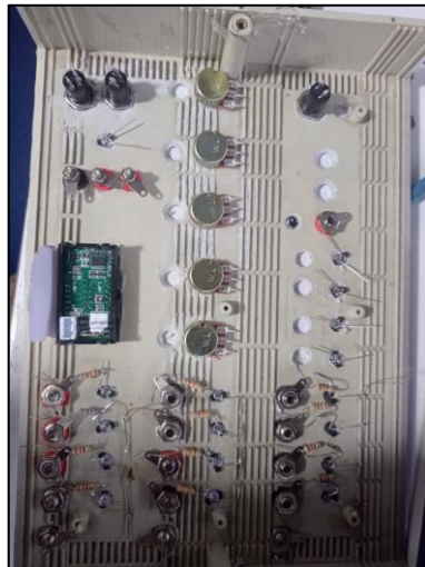
Figura No. 21 Ordenamiento del cableado articulado.
