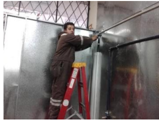
Imagen N° 18. Conexión de las lámparas
