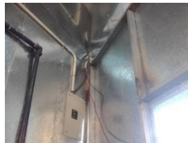
Imagen N° 28. Conectividad de los cables a los breakers
