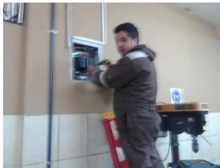
Imagen N° 11. Ubicación y conexión de los breaker
