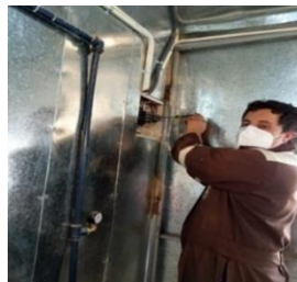
Imagen N° 29. Ubicación de los breaker en la caja térmica
