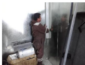
Imagen N° 14. Colocación de los focos de iluminación
