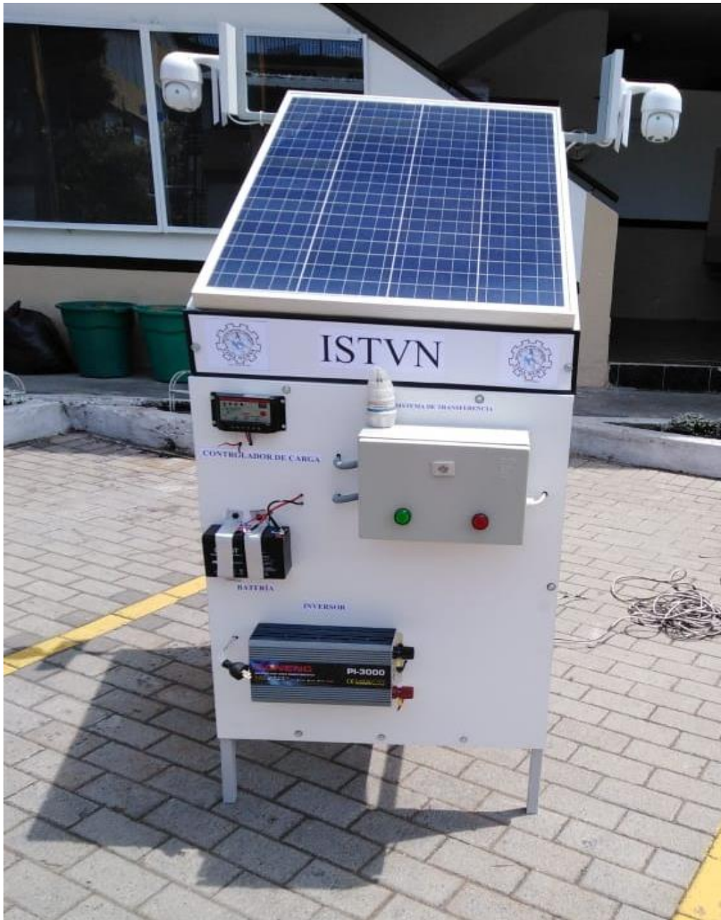
Imagen No. 35 Sistema eléctrico basado en paneles solares para un circuito cerrado de cámaras Elaborado por: Lenin Fernando Perez Mendoza Fuente: Datos de la investigación
