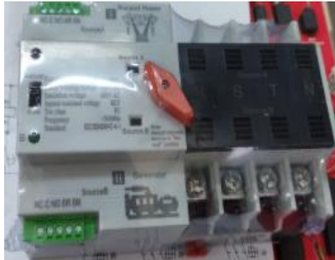
Imagen No. 4 Interruptor de transferencia automático Elaborado por: Lenin Fernando Perez Mendoza Fuente: Datos de la investigación
