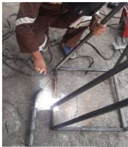
Imagen No. 39 Soldadura Elaborado por: Alejandro Israel Huilca Serrano Fuente: Elaboración propia
