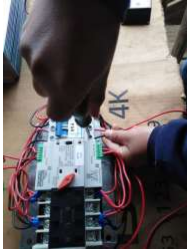
Imagen No. 25 Conexión del inversor hacia el interruptor de transferencia
