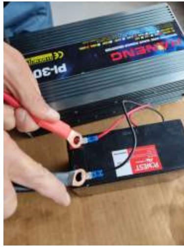
Imagen No. 24 Conexión de la batería al inversor Elaborado por: Cristian Daniel Suntasig Flores Fuente: Datos de la investigación
