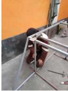
Imagen No. 31 Limpieza de la estructura Elaborado por: Cristian Daniel Suntasig Flores Fuente: Datos de la investigación
