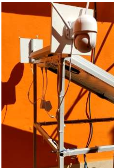
Imagen No. 41 Conexión de las cámaras
