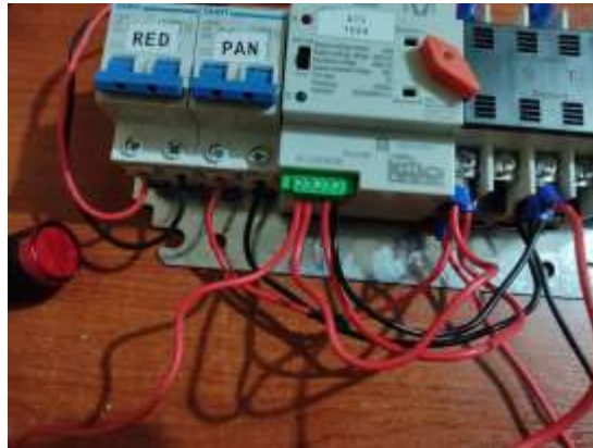
Imagen No. 16 Conexión del sistema de fuerza de la fuente B
