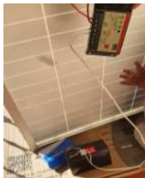
Imagen No. 23 Conexión del controlador a la batería Elaborado por: Cristian Daniel Suntasig Flores Fuente: Datos de la investigación
