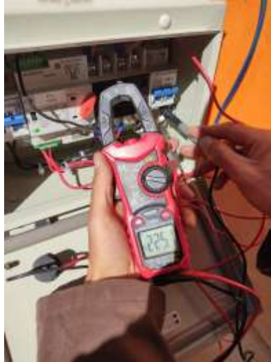
Imagen No. 40 Comprobación en la salida de breaker de carga
