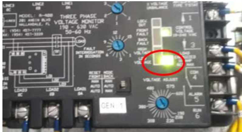
Imagen No. 103 Led indicador falla de voltaje y voltaje bajo Elaborado por: William Alexander Roldan Bastidas Fuente: Datos de la investigación
