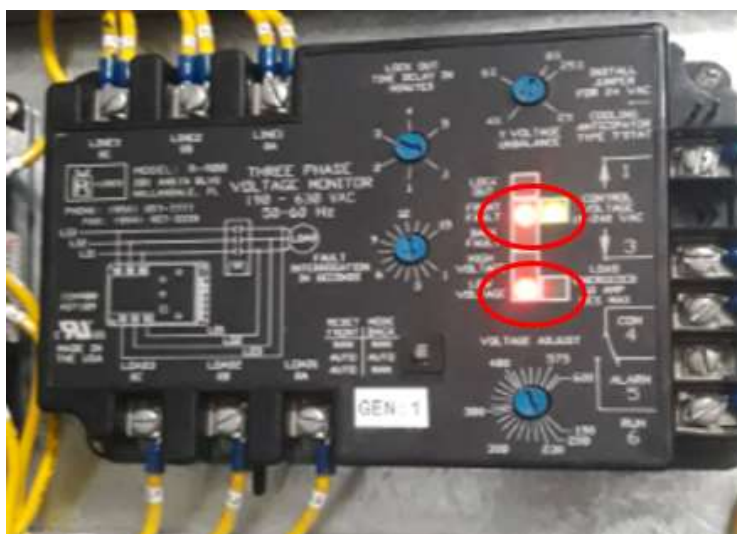
Imagen No. 102 Led indicador falla de voltaje y voltaje bajo Elaborado por: William Alexander Roldan Bastidas Fuente: Datos de la investigación
