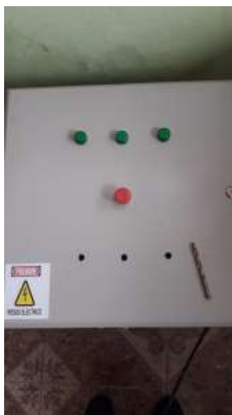
Imagen No. 86 Instalación pulsador emergencia, luz piloto, perforación para selectores Elaborado por: William Alexander Roldan Bastidas Fuente: Datos de la investigación
