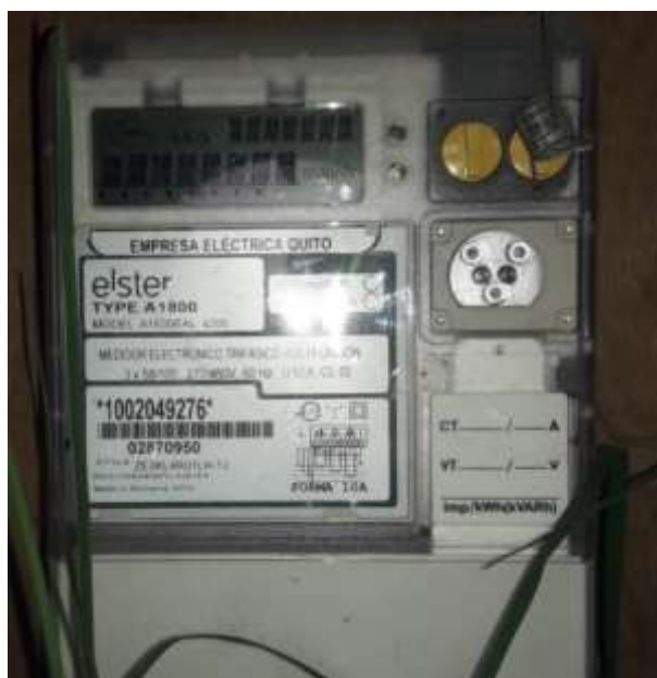
Imagen No. 50 Medidor eléctrico Resiflex Duraflex S.A Elaborado por: William Alexander Roldan Bastidas Fuente: Datos de la investigación
