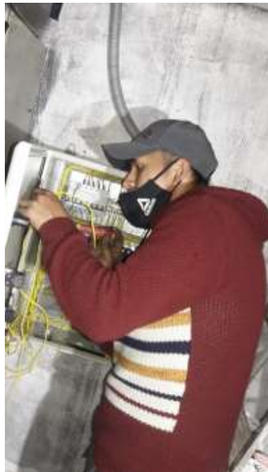
Imagen No. 120 Conexiones eléctricas tablero transferencia Elaborado por: William Alexander Roldan Bastidas Fuente: Datos de la investigación
