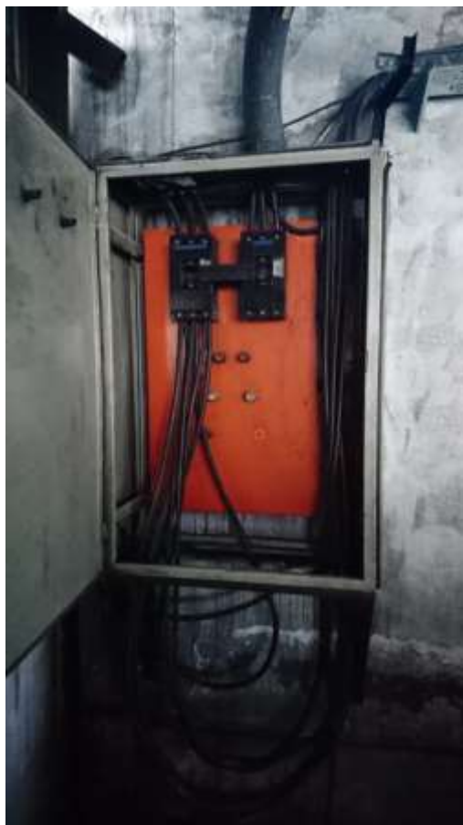
Imagen No. 117 Tablero principal de breaker Red/Generador Elaborado por: William Alexander Roldan Bastidas Fuente: Datos de la investigación
