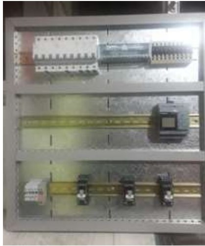
Imagen No. 82 Implementación de breaker, PLC LOGO, relé, fusibles, repartidores de fases. Elaborado por: William Alexander Roldan Bastidas Fuente: Datos de la investigación
