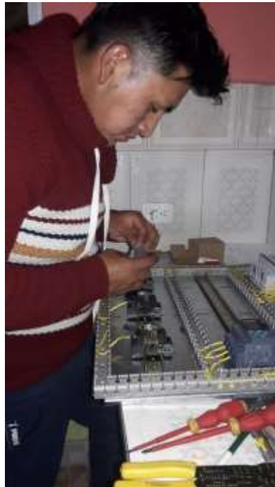
Imagen No. 84 Conexión (breaker, PLC LOGO, relé, etc.) en el sistema de control
