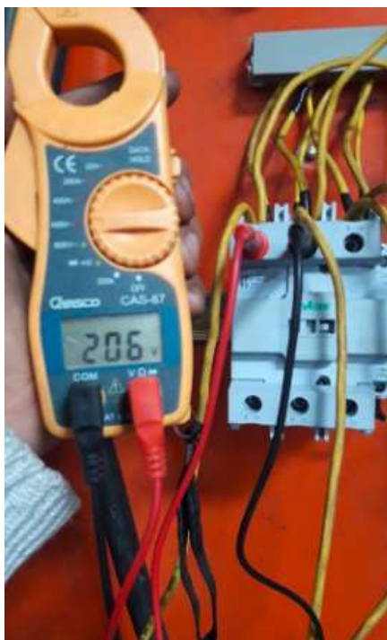
Imagen No. 99 Medición de voltaje Contactor EEQ Elaborado por: William Alexander Roldan Bastidas Fuente: Datos de la investigación
