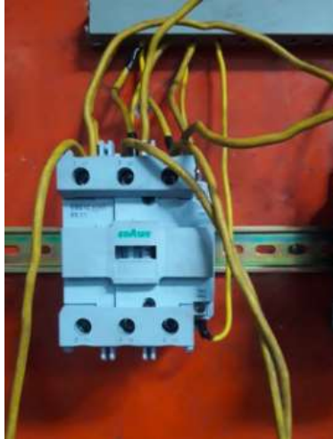
Imagen No. 113 Activación de contactores en sistema manual
