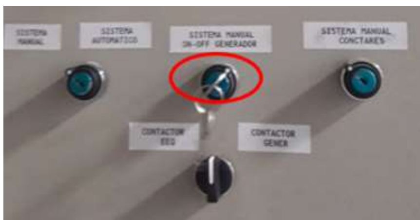
Imagen No. 112 Desactivación automática y activación sistema manual
