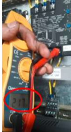
Imagen No. 107 Activación de supervisor de fases, contactor generador y led indicador Elaborado por: William Alexander Roldan Bastidas Fuente: Datos de la investigación
