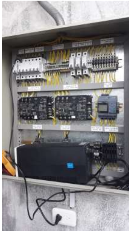
Imagen No. 92 Instalación y conexión UPS 110VCA Elaborado por: William Alexander Roldan Bastidas Fuente: Datos de la investigación
