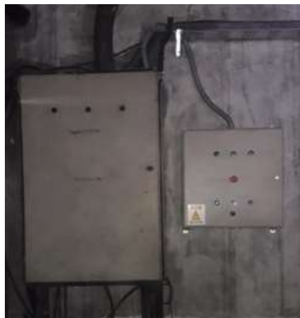
Imagen No. 88 Instalación de tablero de transferencia junto a tablero de breaker principales Elaborado por: William Alexander Roldan Bastidas Fuente: Datos de la investigación
