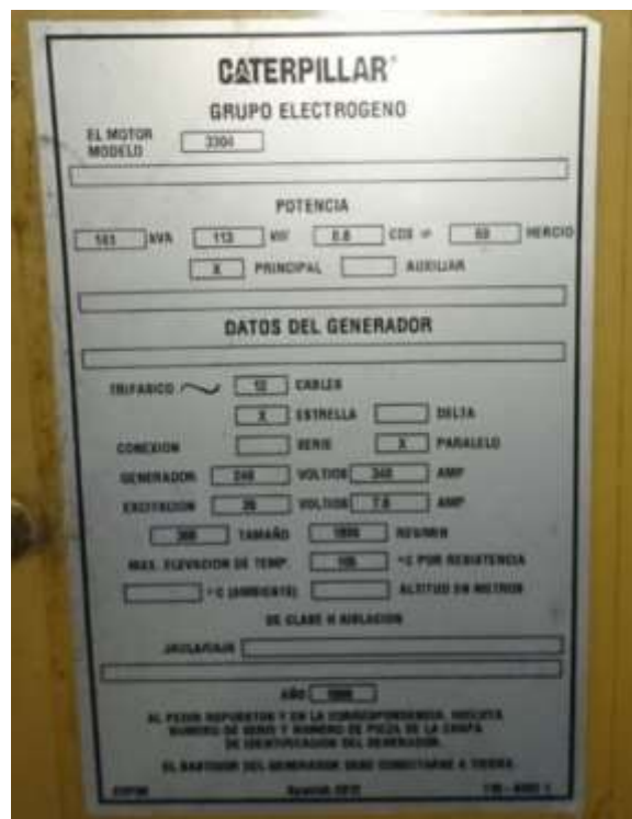
Imagen No. 48 Placa de datos generador CATERPILLAR 3304
