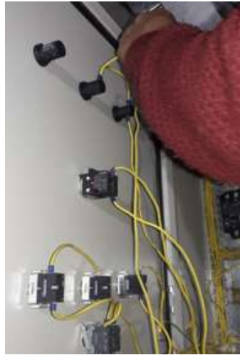
Imagen No. 89 Conexión eléctrica sistema manual Elaborado por: William Alexander Roldan Bastidas Fuente: Datos de la investigación
