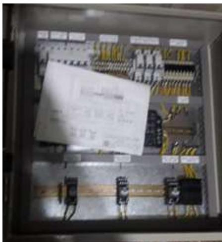
Imagen No. 85 Sistema de control, porta fusibles interconectados Elaborado por: William Alexander Roldan Bastidas Fuente: Datos de la investigación
