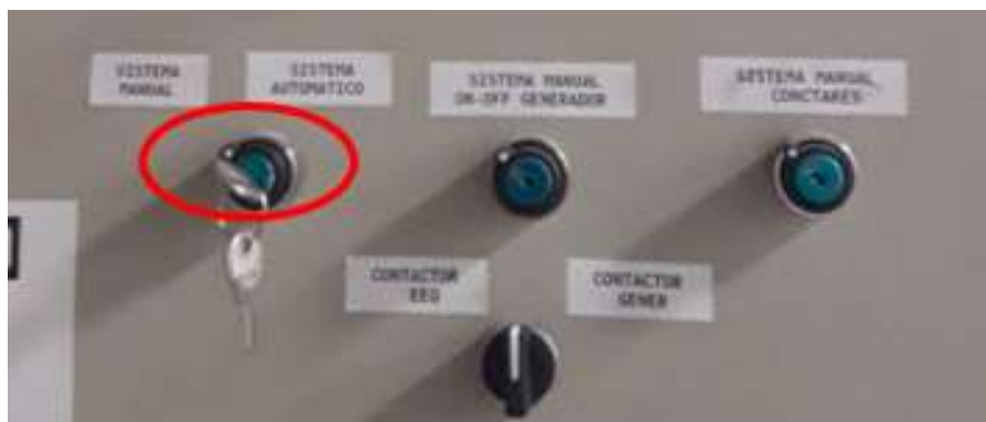
Imagen No. 111 Desactivación automática y activación sistema manual
