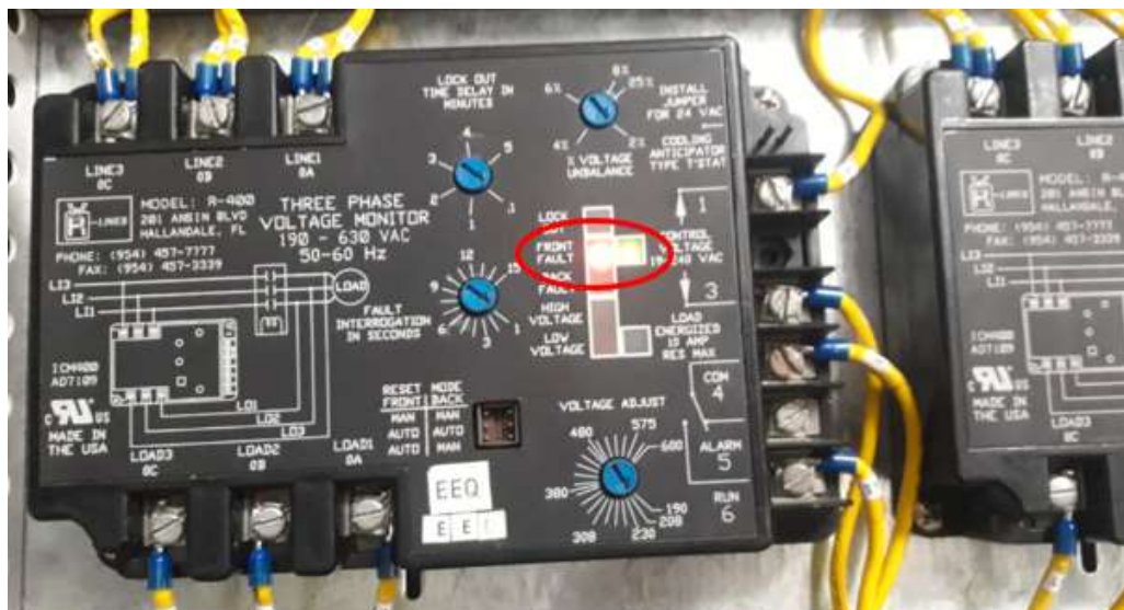
Imagen No. 100 Led indicador falla de voltaje
