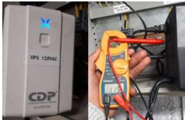
Imagen No. 114 Activación de contactores en sistema manual
