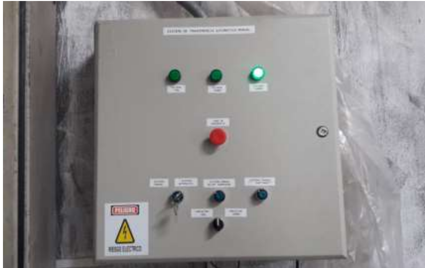
Imagen No. 121 Tablero de Transferencia Automática/Manual Elaborado por: William Alexander Roldan Bastidas Fuente: Datos de la investigación
