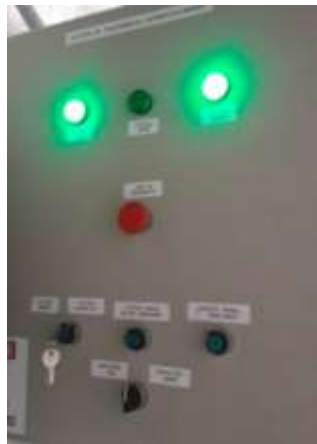
Imagen No. 108 Activación contactor EEQ y desactivación del contactor generador Elaborado por: William Alexander Roldan Bastidas Fuente: Datos de la investigación
